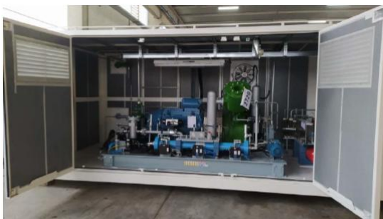
5 pav. Kompresoriaus konteineris
